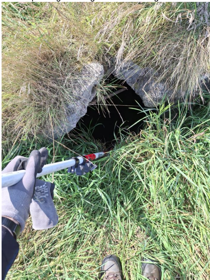
Figur 2. Station 2.030: Rørudløb løber direkte i bro, med dette hul som er farligt.
